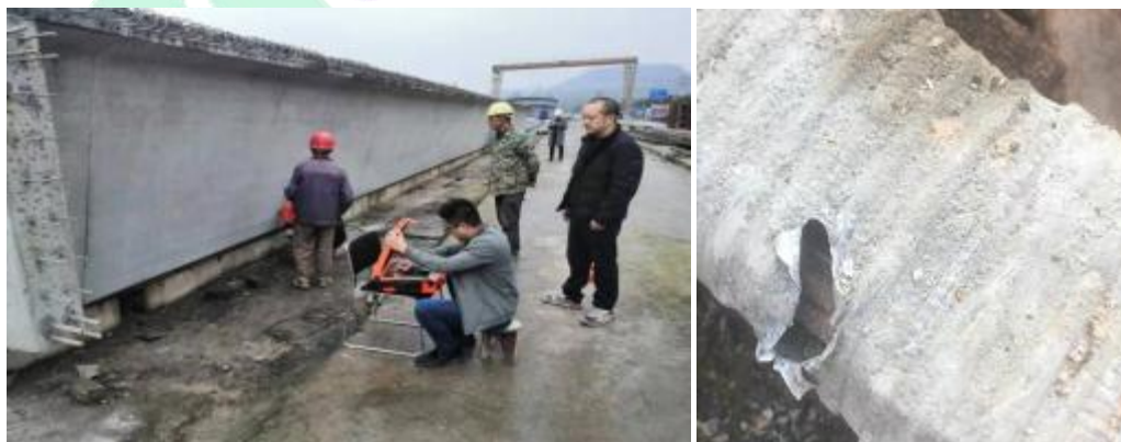
现场测试及问题顶板孔道
