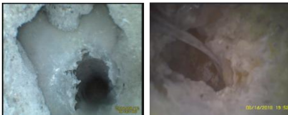
某隧道右拱腰 777-778、隧道拱顶 771.5-773
