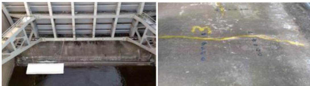
照片 2-5-4 现场裂缝状态及测试场景
