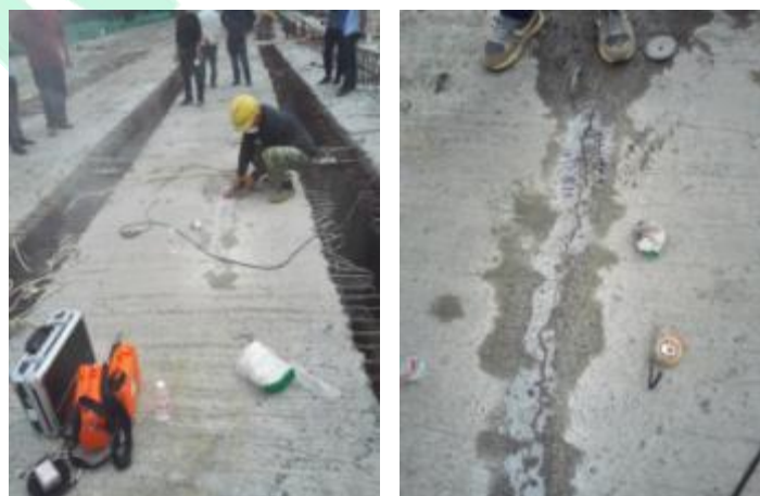
照片 2-5-5 检测对象场景 (左) 裂缝位置图 (右)
