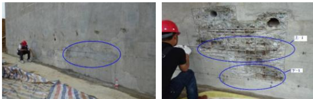
照片 5- 3-5 对应缺陷位置（左：西侧（上游面），右：东侧（下游面））
