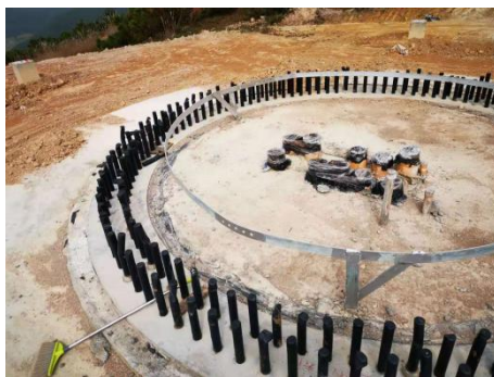
风机基础及可见缺陷情况
