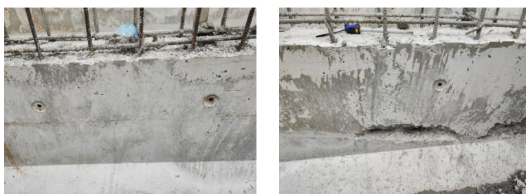
健全和缺陷部位（左：健全位置，右：缺陷位置）
