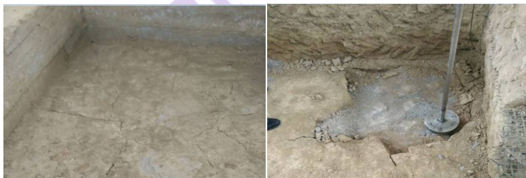
原地基表面（左）和去除表面后（右）的地基
