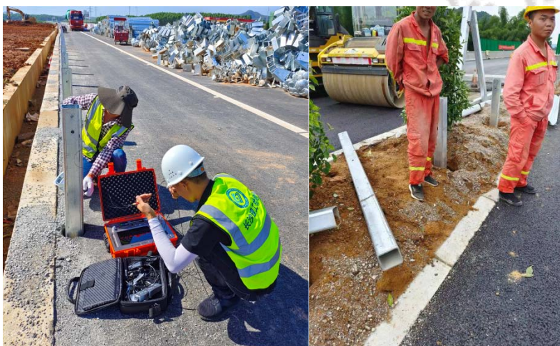
现场测试照片
