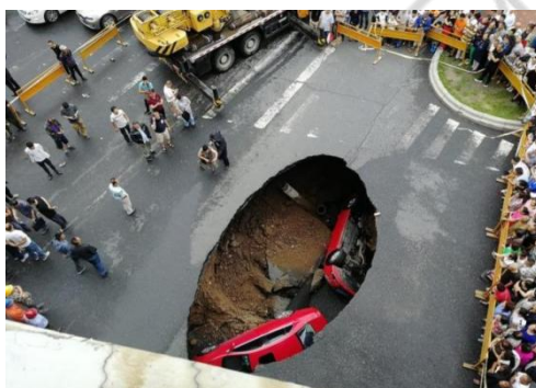
某城市道路地下空洞
