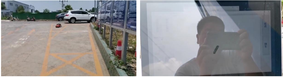
某厂房道路缺陷检测
