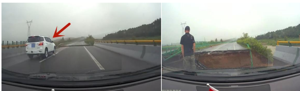
哈牡高速坍塌事故现场
